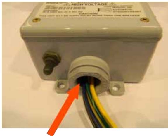
Рис. 5. Вид на кабельный ввод.
